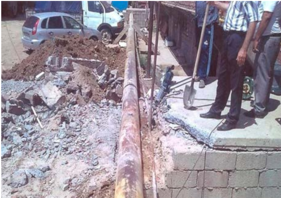
Республика Дагестан, самовольно построенный многоквартирный жилой дом на газовой трубе среднего давления
