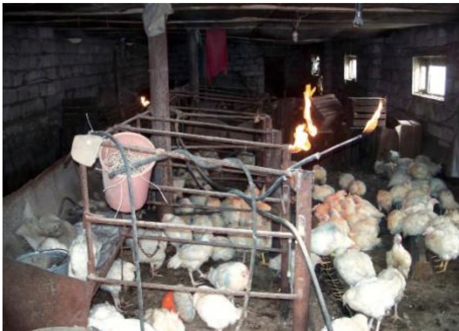
Республика Дагестан, птичник. Установлено несертифицированное оборудование для обогрева
